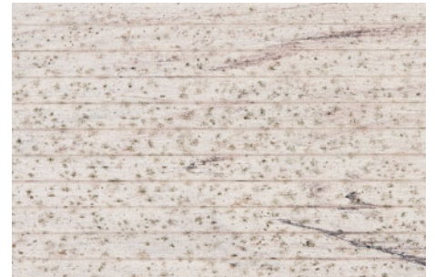
Stockflecken/Schimmel auf der Oberfläche
