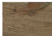
Raue Stellen auf der Holzoberfläche
