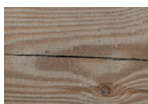
Spannungsrisse durch die Holz Trocknung
